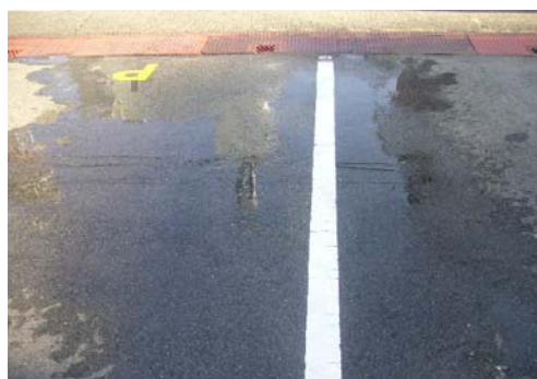
写真11 ①白線の水ぬれ状況
