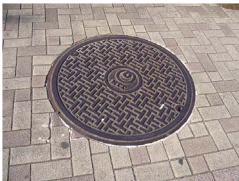
写真8 ⑨マンホール (鉄製)
